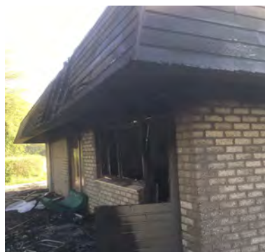
Het toiletgebouw was niet meer te herstellen
